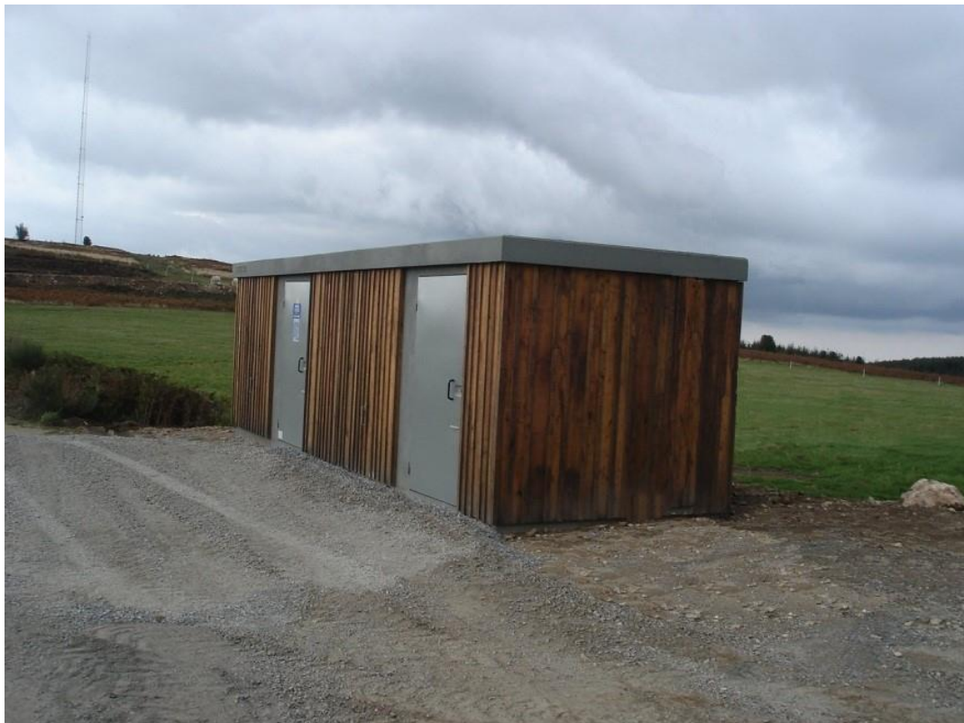
Poste de livraison du parc éolien de Margnès
